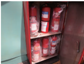
▲ 廠內消防設備
